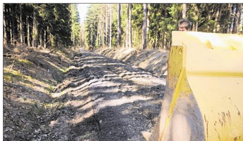
Neu aufgebaut wird die Straße nach Frankenhof derzeit: Noch regieren hier die Baumaschinen, bald kommt eine neue Decke drauf.
